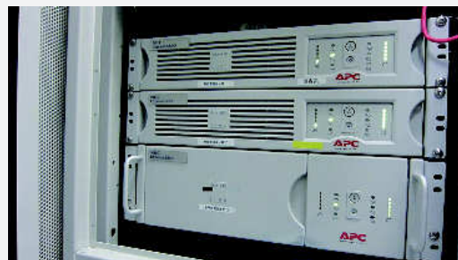
▲サーバーなどで利用される無停電電源装置
